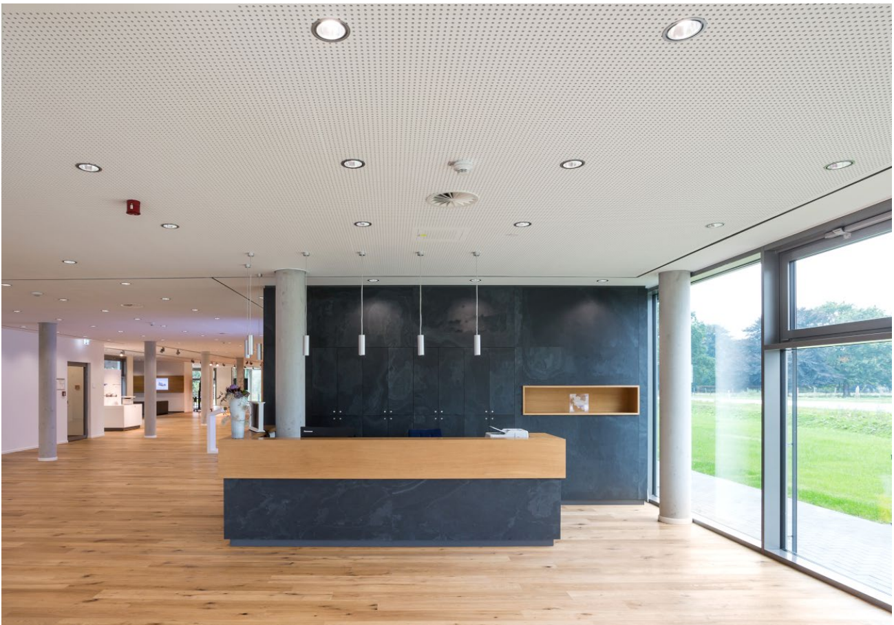
Abb. 7: Klimadecke mit gelochten Gipskartonplatten und diversen Einbauten (Licht, Luft, Sprinkler, Rauchmelder)
