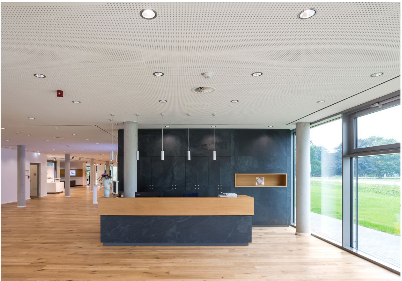
Fig. 7: Plafond climatisé avec plaques de plâtre perforées et diverses installations (lumière, air, sprinkler, détecteur de fumée)
