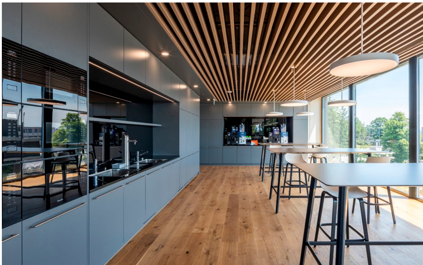
Fig. 10: I baffle sono una tipologia di assorbitore da soffitto. L'immagine mostra i baffle per riscaldamento/raffrescamento con un inserto aggiuntivo di materiale fonoassorbente all'interno (tessuto non tessuto acustico e materassini di lana minerale).
